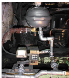
大型エアドライヤー 鋳物工場 平成17～
