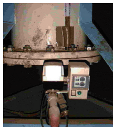
大型エアフィルター セメント平成13～
