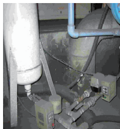
末端のドレンポット 製鐵所 平成3～
